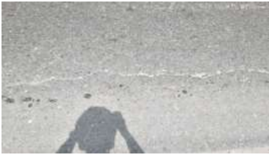
Gambar 16. Retak memanjang Sumber :Lokasi penelitian
