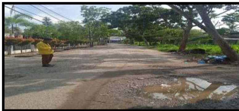
Gambar 4. Foto Kondisi jalan Ruas Jalan SMU 3 STA 0+200-0+400
